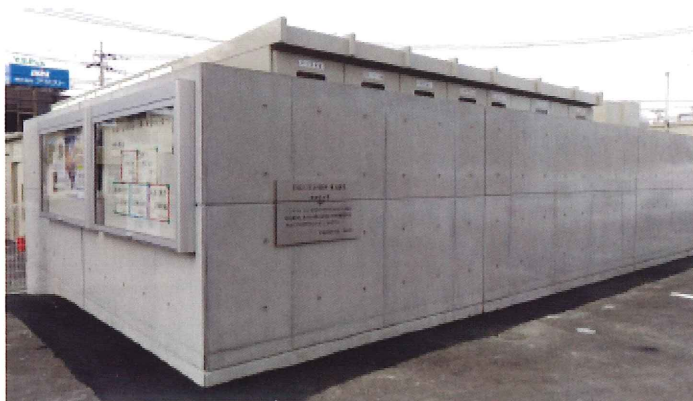
電気設備周囲への塀設置の例
